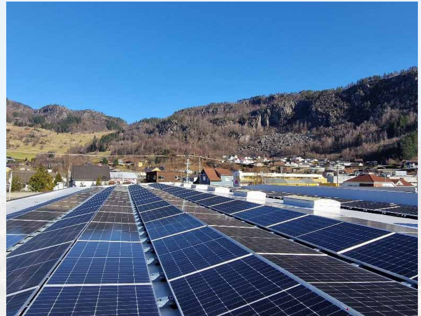
Kortreist kraft fra solcellene på fabrikk-taket.
